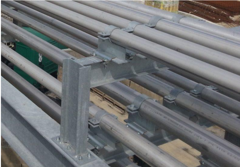
SUPPORTAGE INDUSTRIEL DE TUYAUTERIES
